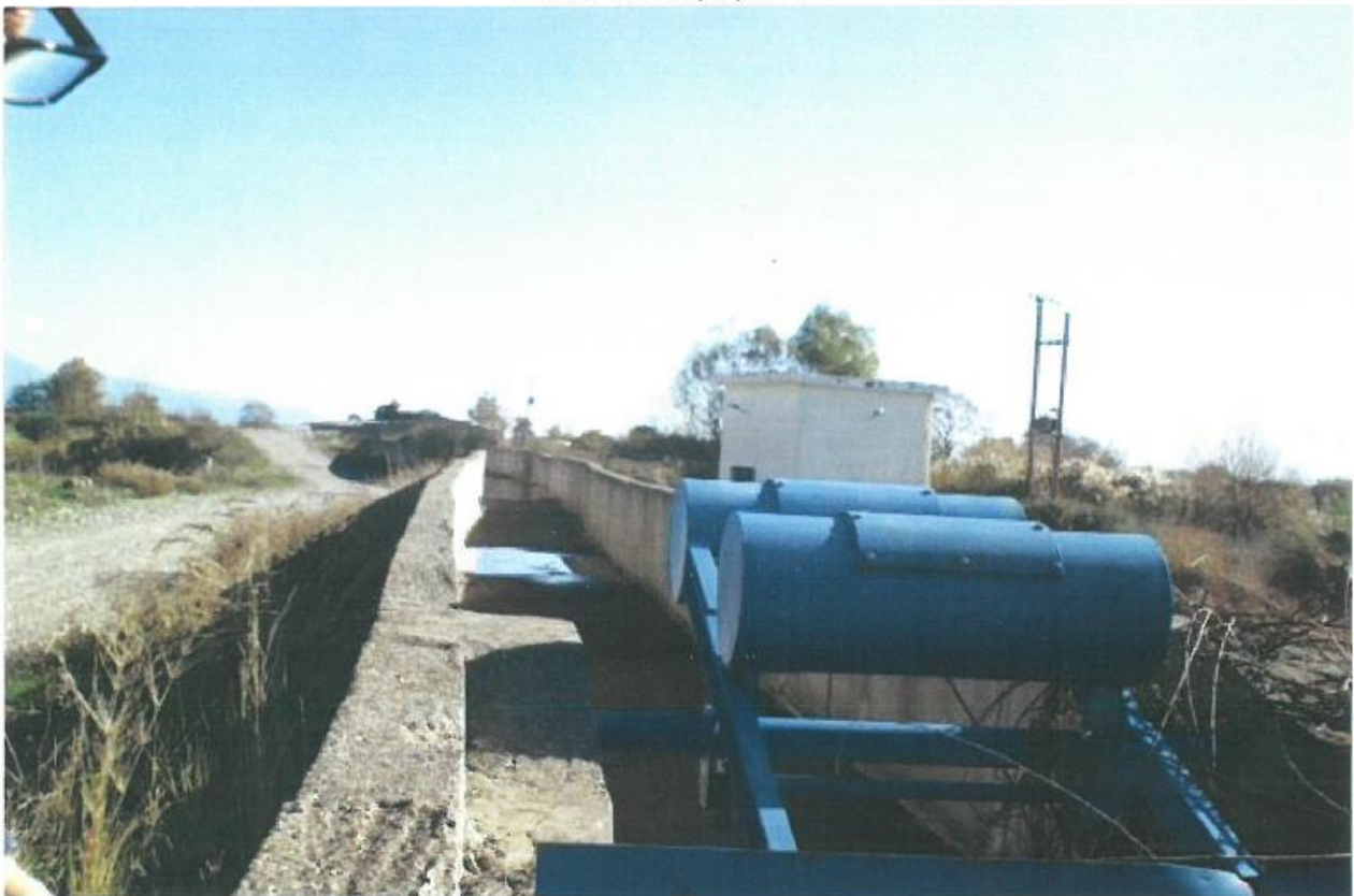
Εικ. 14 Διώρυγα Δ2 με ρουφράκτη
