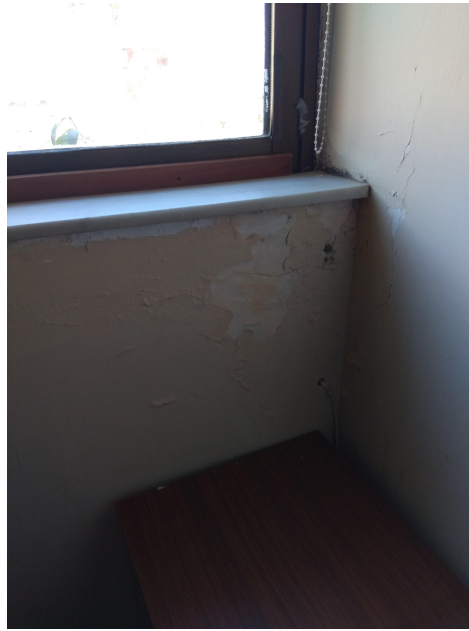
Εικ. 1 Αποσάθρωση εσωτερικών επιχρισμάτων λόγω υγρασιών
