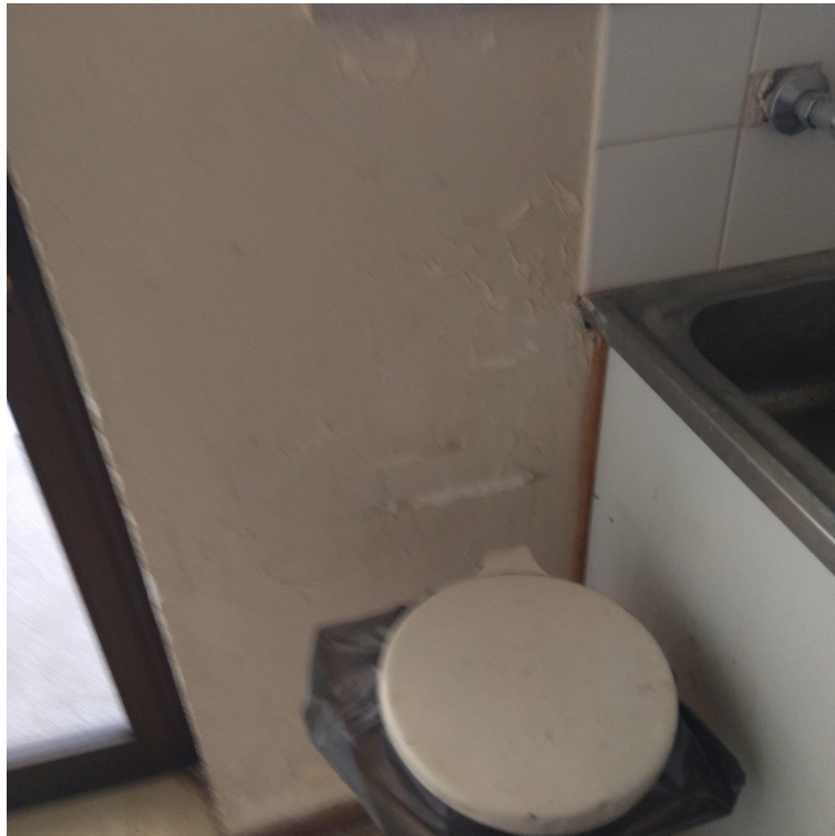
Εικ. 2 Αποσάθρωση εσωτερικών επιχρισμάτων λόγω υγρασιών
