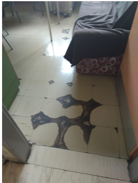
Εικ. 8: Φθαρμένα πλαστικά δάπεδα
