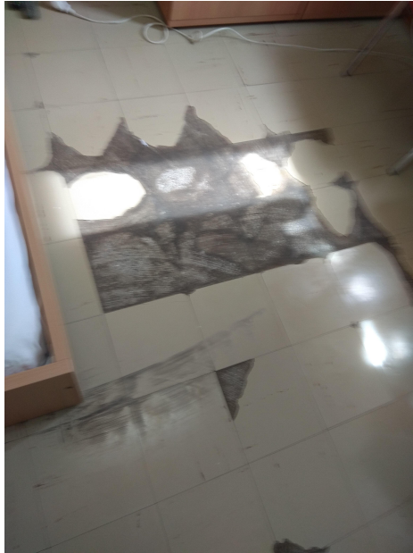
Εικ. 7: Φθαρμένα πλαστικά δάπεδα
