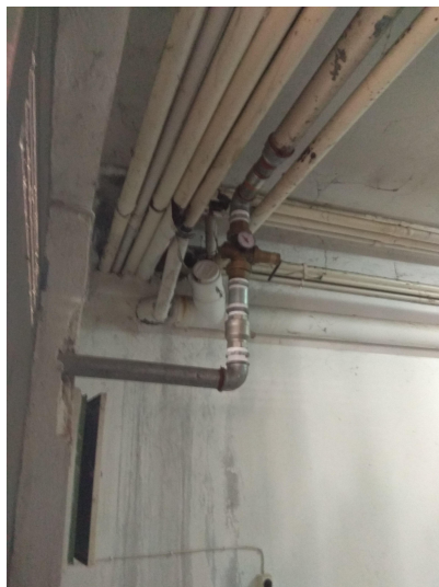
Εικ.9: Προβληματικές σωληνώσεις αποχέτευσης
