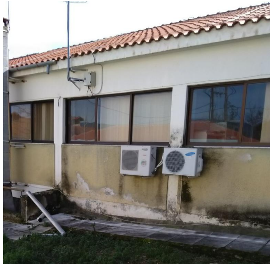
Εικ. 1 Αποσάθρωση εξωτερικών επιχρισμάτων λόγω υγρασιών
