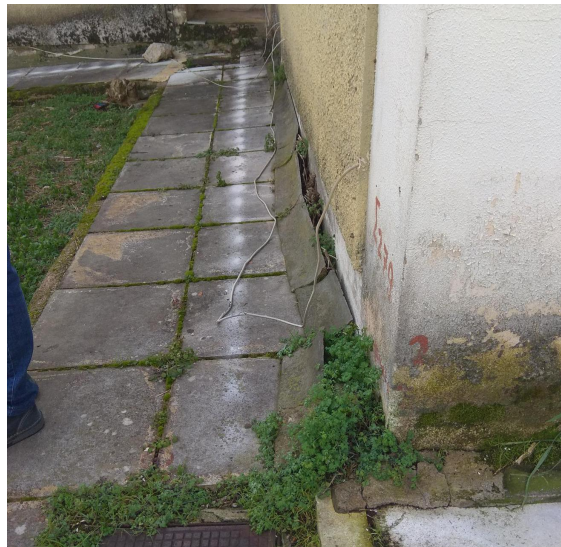
Εικ. 2 Διαφορικές καθιζήσεις περιμετρικά του κτιρίου
